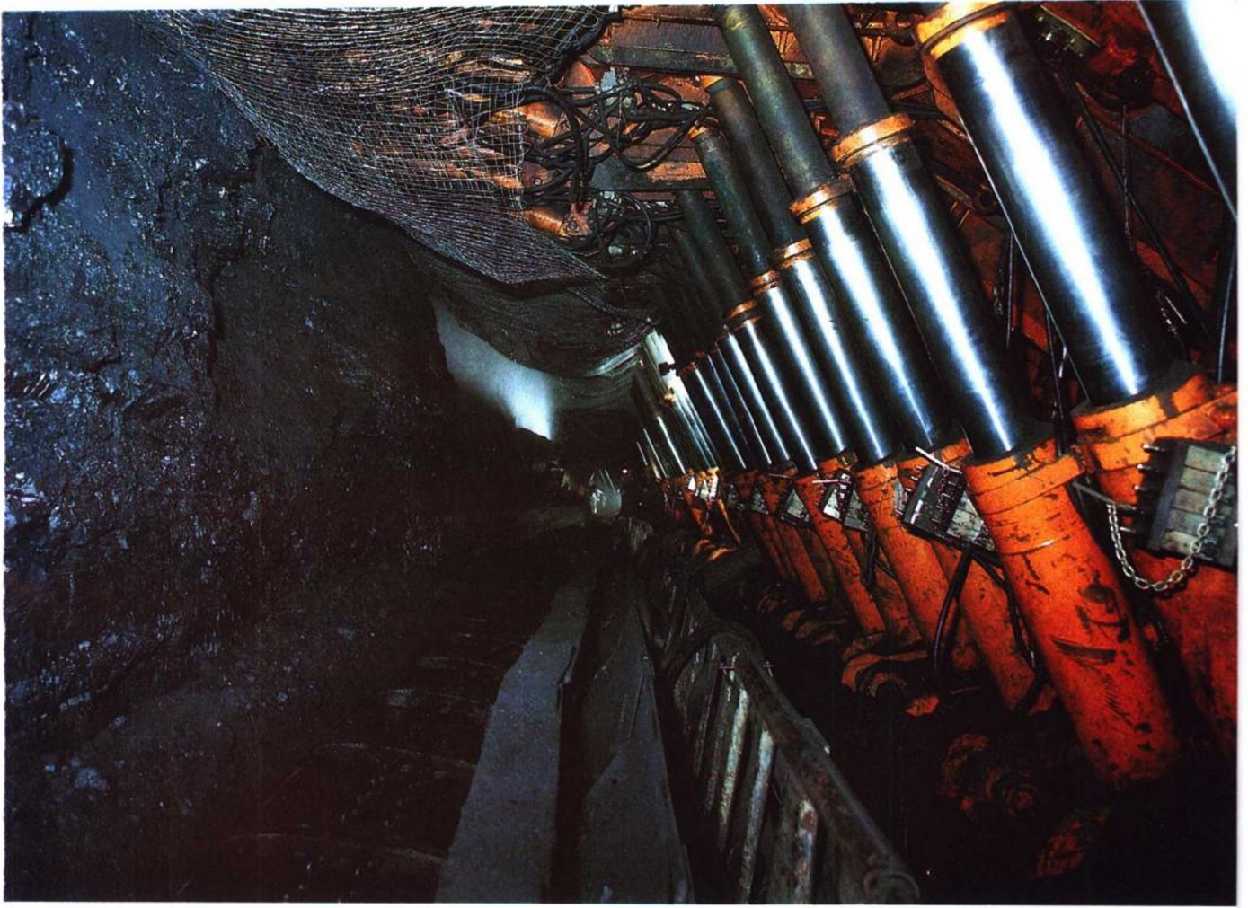
开滦矿务局范各庄矿综采工作面使用引进掩护式液压支架
