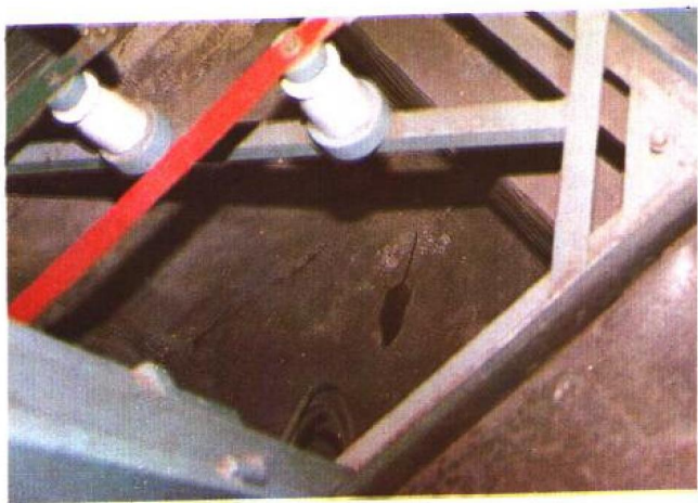
图6 老鼠引起事故现场
