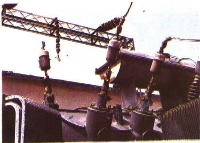
图5 变电站电气火灾现场之三
