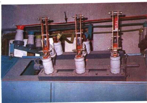
图10 带负荷拉刀闸事故现场
