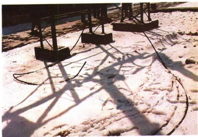
图2 污闪事故现场之二
