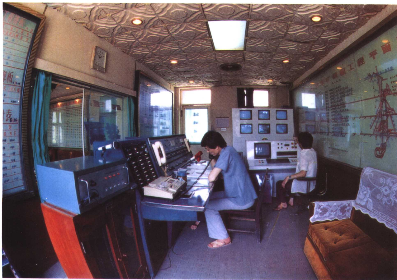
天府矿务局磨心坡矿生产调度室
