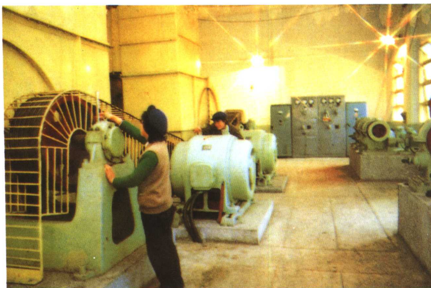
矿井抽风机房
