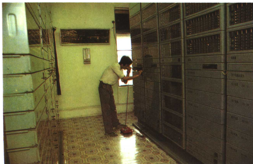
矿区程控电话交换机房
