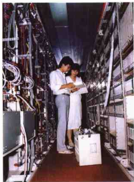
八十年代的交换机房一角
