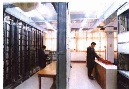
穗、深、港光纤通信系统深圳终端机房
