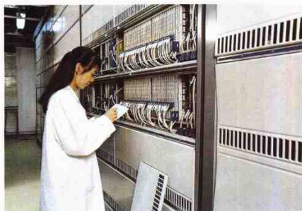
九十年代的程控交换机房
