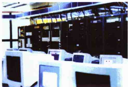
深圳数据通信高速发展 图为数据局机房
