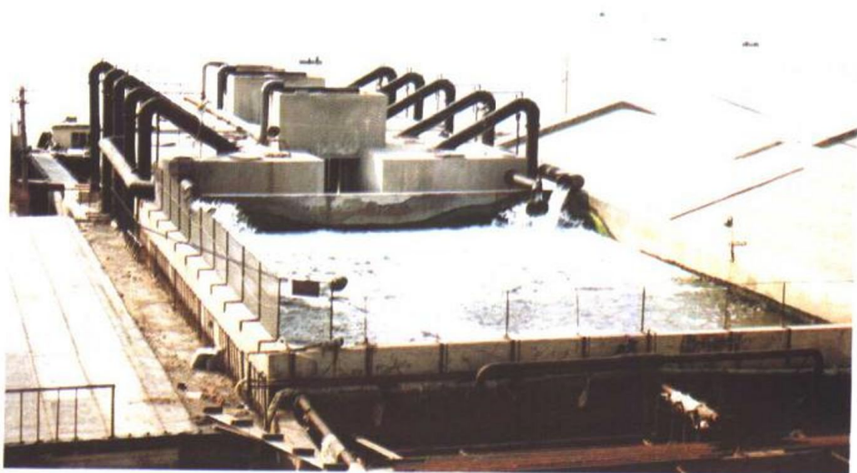
无阀滤池——现代化水净化设施 每小时处理海水2000吨
