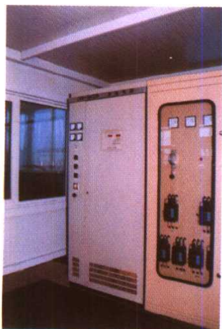
微机控制免维护 直流电源设备
