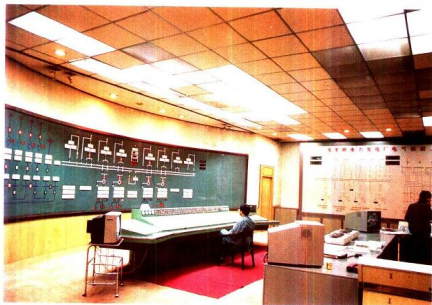
龙羊峡水电站中央控制室
