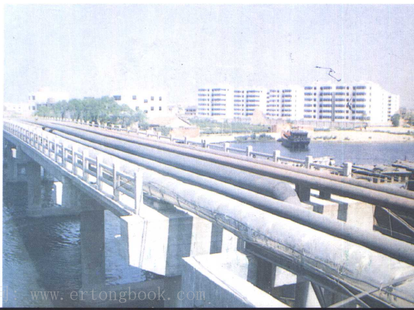
昆山经济技术开发区（城市新区）集中供热、供气设施。
