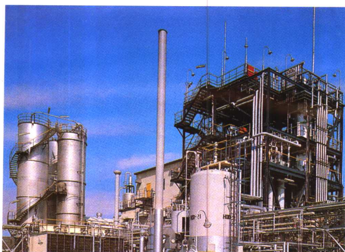
彩图2-4-21 中柱式悬挑钢楼梯用于室外工业设备之二(国外工业)
