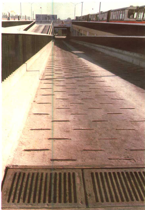
彩图2-1-11 防滑耐磨坡道细部每50cm间埋 \phi 20 螺纹钢做防滑条(上海公交公司八场)
