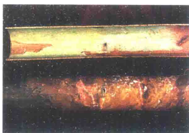
5-8 凝汽器管汽侧氨腐蚀
