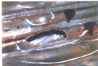
图 4-5 酸腐蚀引起的脆爆口
