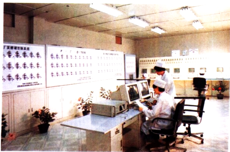
发酵车间工艺控制系统
