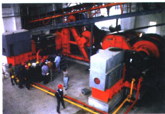
阳泉煤矿 2 × 1000kW电机 2 × CST1950K
