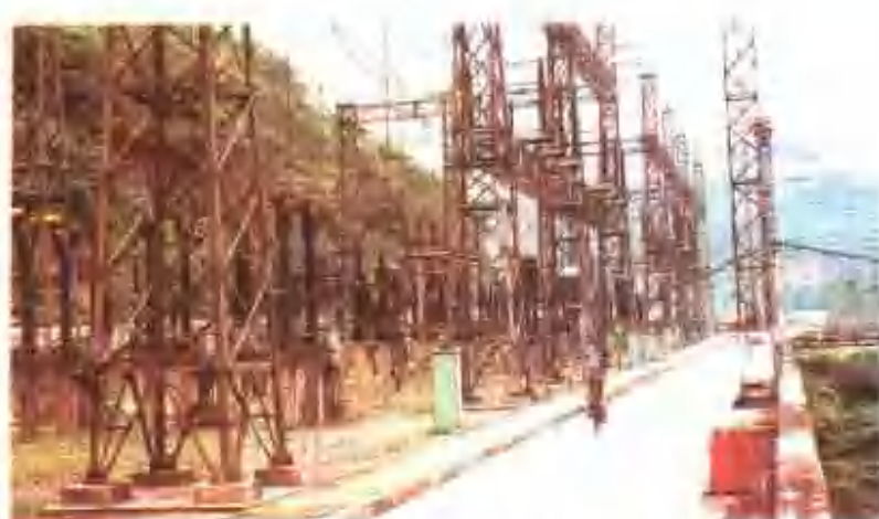
太平驿变电站
