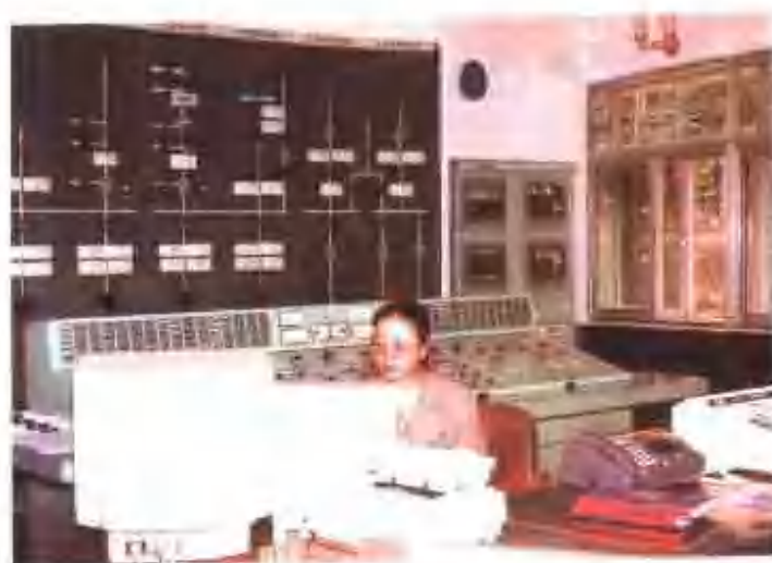
映电总厂耿达电站中控室
