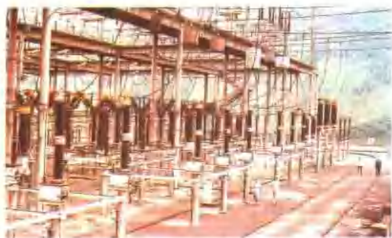
映秀湾二台山220千伏联合开关站
