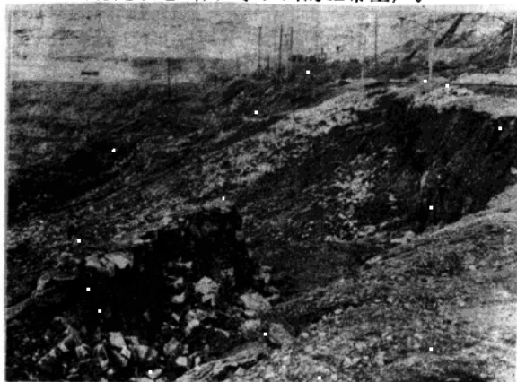
图2 抗滑桩前滑落桩后边坡保持稳定
