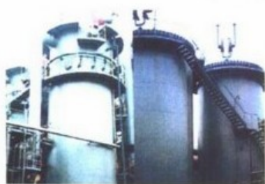
为镇江焦化厂制造安装的湿式电除尘器及七氟式脱硫塔
