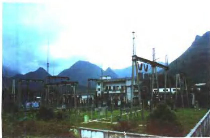
110KV木崙变电站
