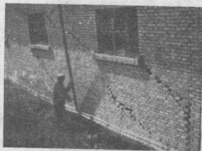
照片8 砖墙下沉开裂
