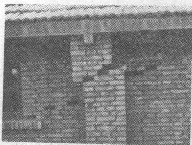
照片4 砖附壁柱断裂错位
