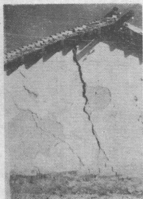
照片7 土坯房山墙裂断
