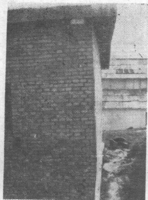
照片3 库房倾斜、裂缝
