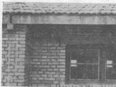
照片5 钢筋混凝土圈梁断裂
