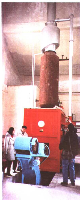
北 潞春小区垃圾站的再 燃式多用焚烧炉
