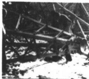
图 1-8 500kV 线路 覆冰引起结构件损坏
