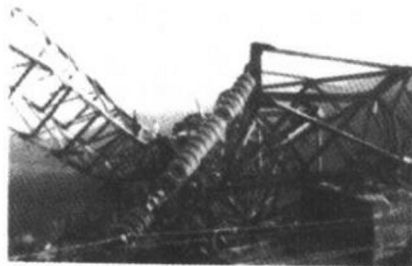
图 1-6 500kV 线路 覆冰引起杆塔完全倒毁
