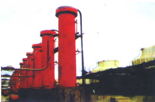
梁北矿东风井冷冻站
