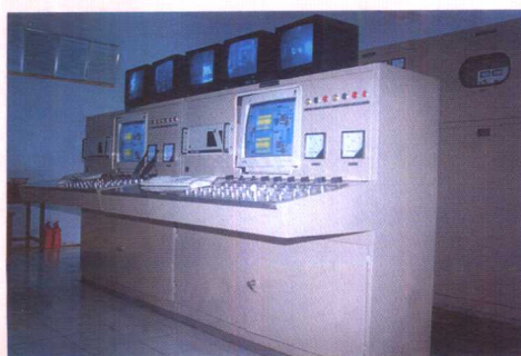
电炉除尘系统监控室
