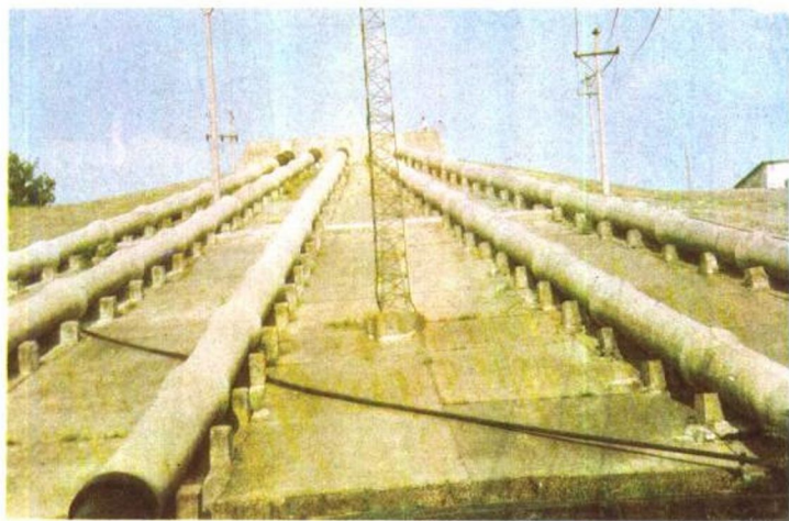
▲图为大岗坡电力抽水机站一级站输水管道。
