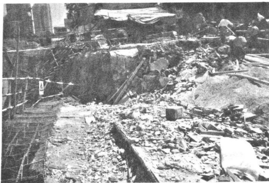
图 1-3 深圳新世界大厦基坑失稳情景
