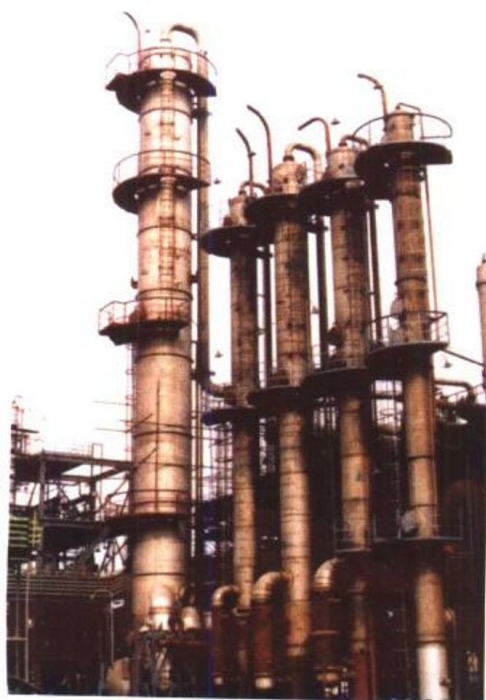
压力容器及非标化工设备
