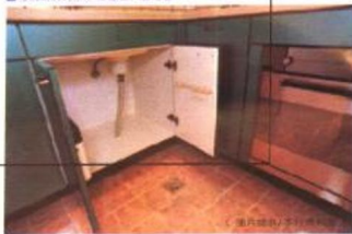
■ 暗藏厨房的排水管道是严重隐患
