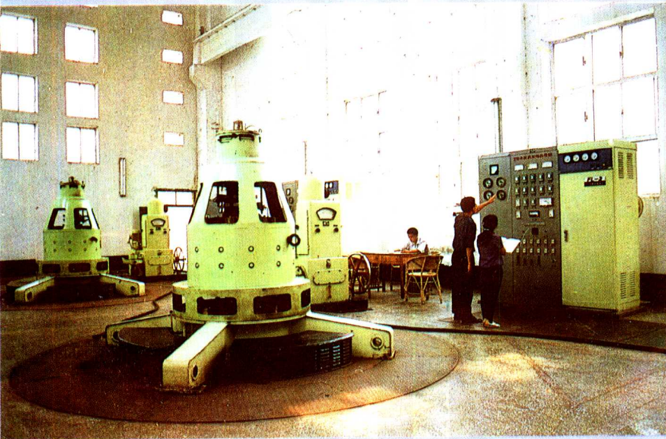
◀大溪河二级电站水机室
