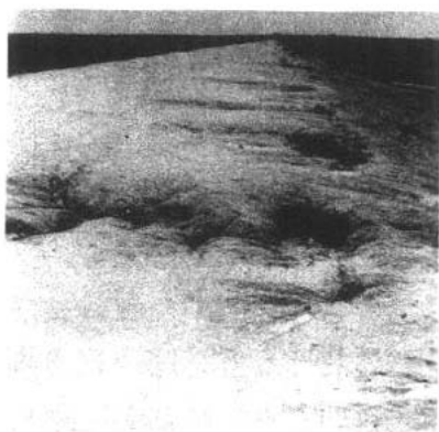
图 2-2 17 号坝顶淋蚀洞穴
