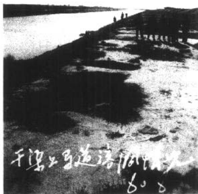
图 2-5 干渠上马道溶蚀洞
