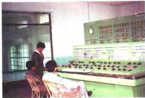
两河口电站机房
