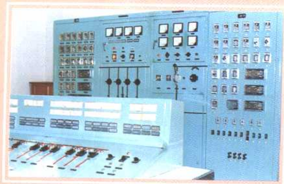
△ 电力公司县城电力控制室
