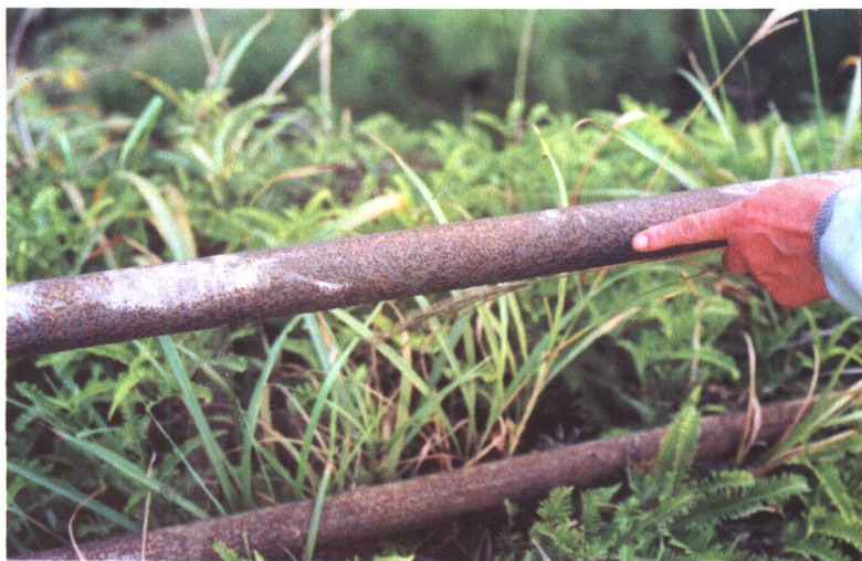
重庆南山金属栏杆受酸雨危害腐蚀状
