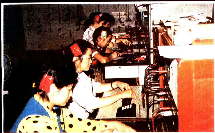
▼ 县邮电局电话交换室 (向华田摄)
