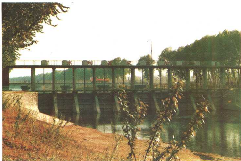
◀ 马颊河节制闸
