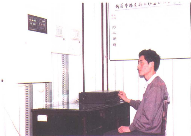
档案库房防盗防火中心控制室
