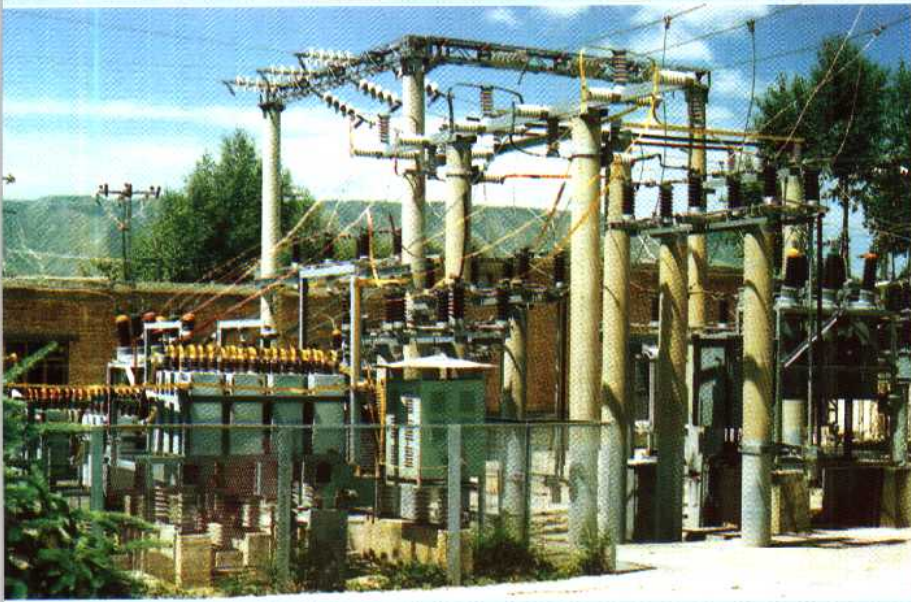
巴燕镇变电所
