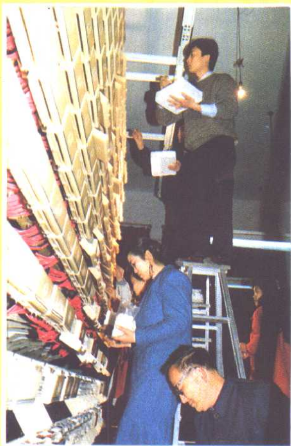
△ 三万门数字程控市话交换机割接现场
