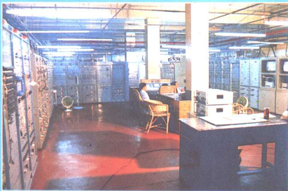
△国产 600 路电子管微波设备
