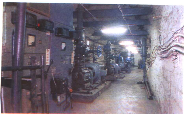
井下排水泵房
