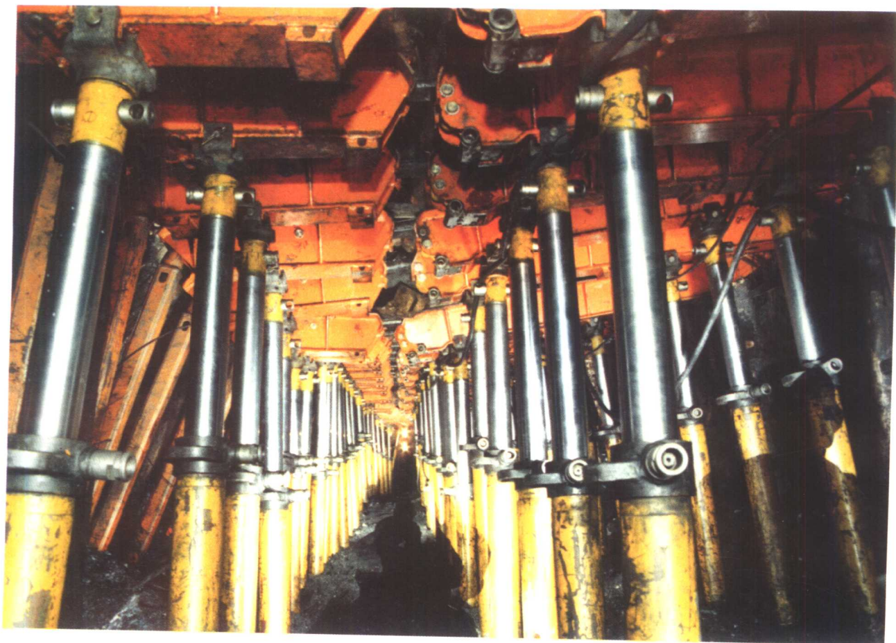
井下推移顶梁支护
