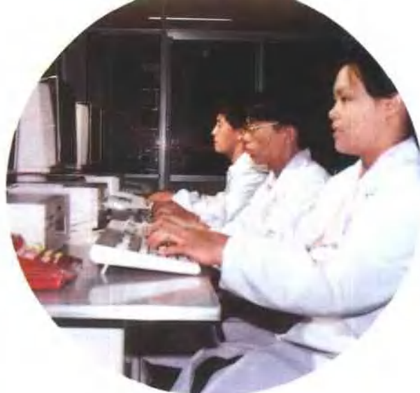
△ 郴州邮电局程控交换机房
