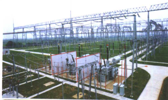
500 千伏的东善桥变电站主变
