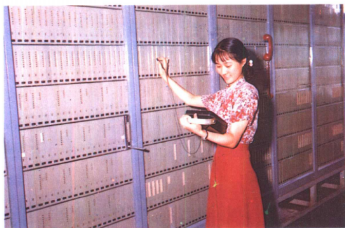
县邮电局自动电话机房
