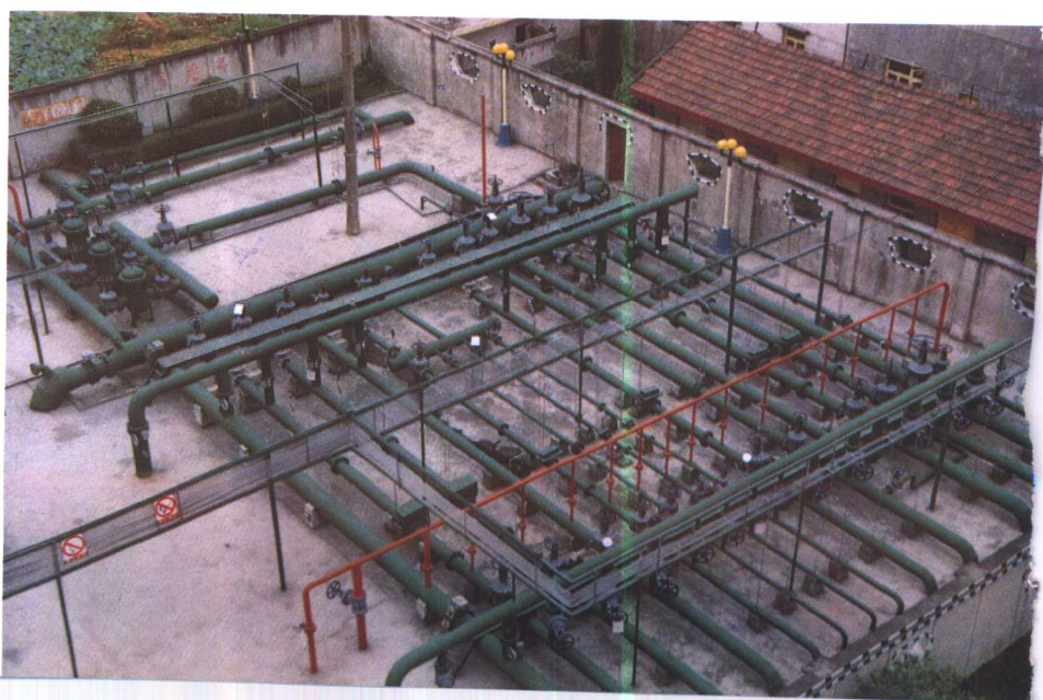
天然气配气站管道场
