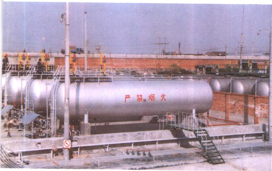
液化石油气储气罐
