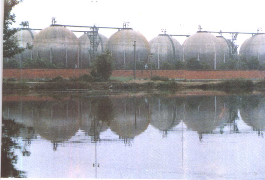
天然气 高压球型储气罐
