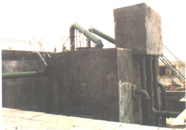
城区供水系统一角
