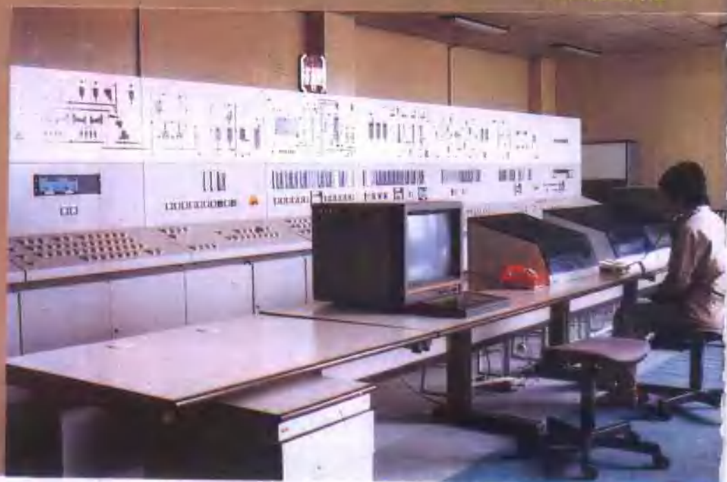
中心控制室内景
