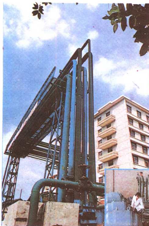
▽现代输卤管道和加工压泵房
