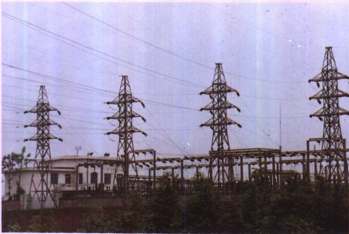
◀ 珠江镇 110 千伏变电所
