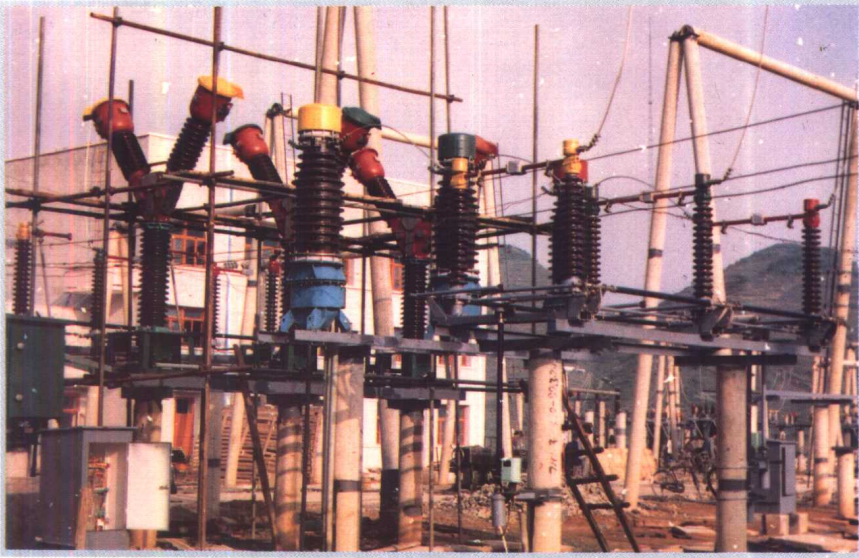
110KV 变电站一角
