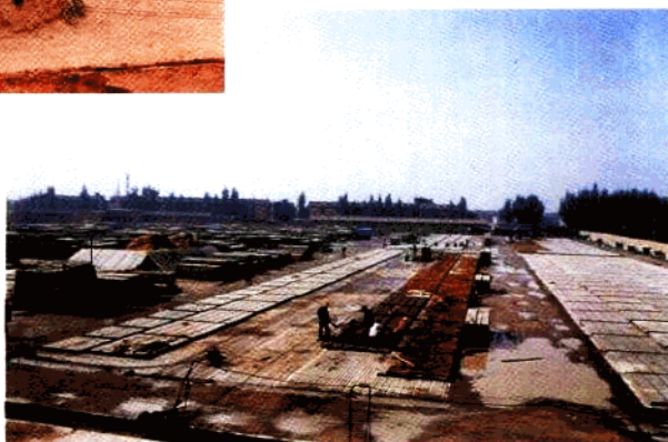
兰州市安宁区建筑 预制构件厂生产区 (1986 年)
