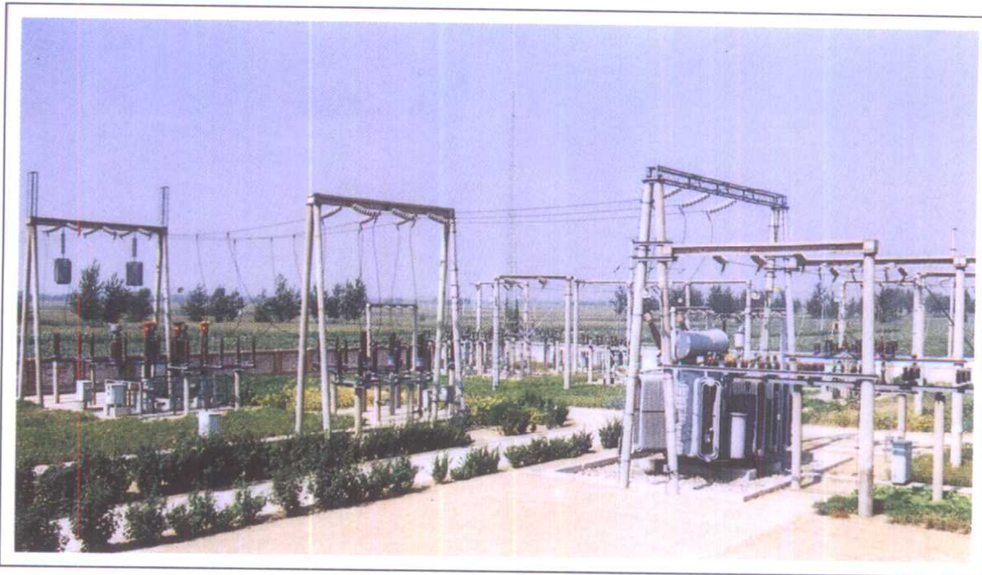
章台110千伏变电站
