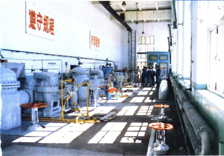
秦皇岛输油站原油外输泵房
