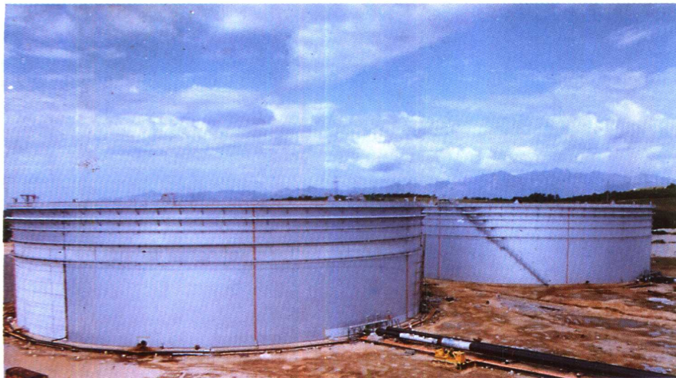
亚洲最大的储油 罐——秦皇岛 10 万 米 3 金属储油罐
