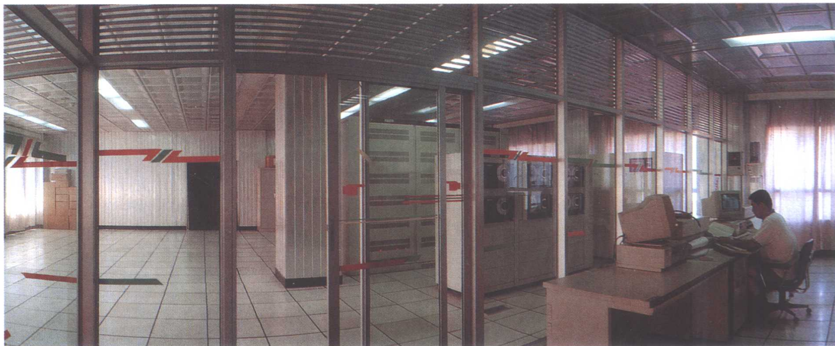
县邮电局万门程控电话交换机机房
