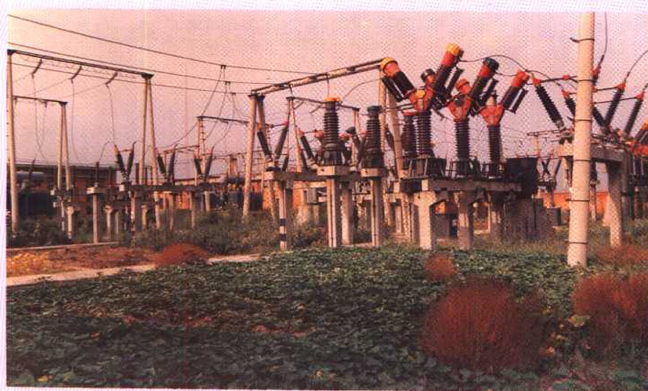
上、110KVA 變電站
